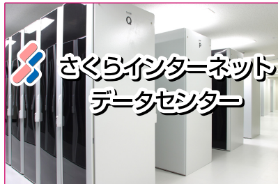
都市型データセンター
